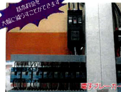
低圧電力（動力 200V）の基本料金を下げるために開発された商品です。
